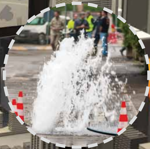
水道管の破裂
